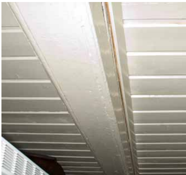
Over: Bjelketak fra rom mot nordøst. Helstaffprofil på bjelker.
